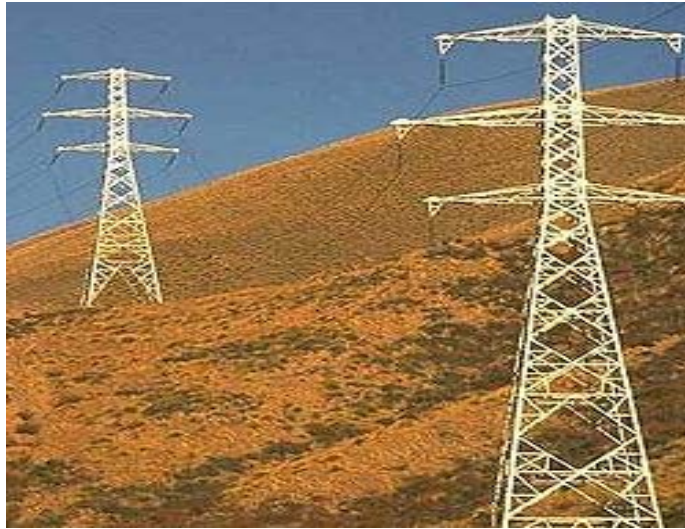
Gambar 2.6 Saluran Udara Tegangan Ekstra Tinggi
